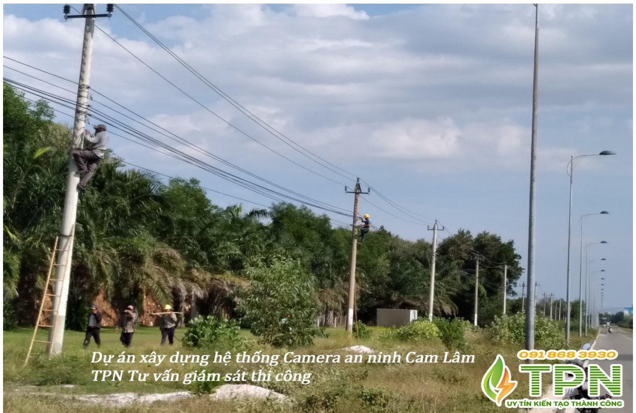
Dự án xây dựng hệ thống Camera an ninh Cam Lâm
